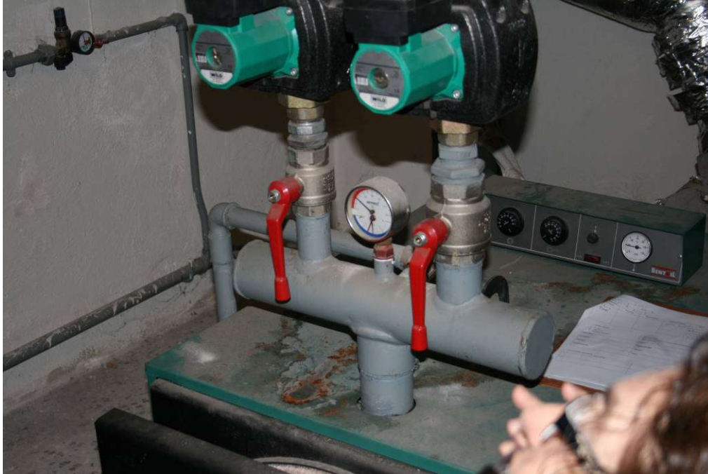
Μη μονωμένοι σωλήνες θέρμανσης
