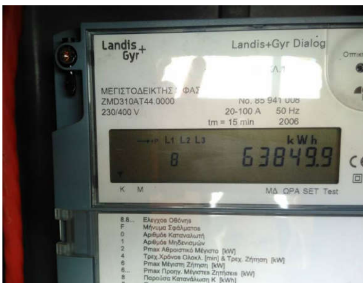
Μετρητής ηλεκτρικού ρεύματος
