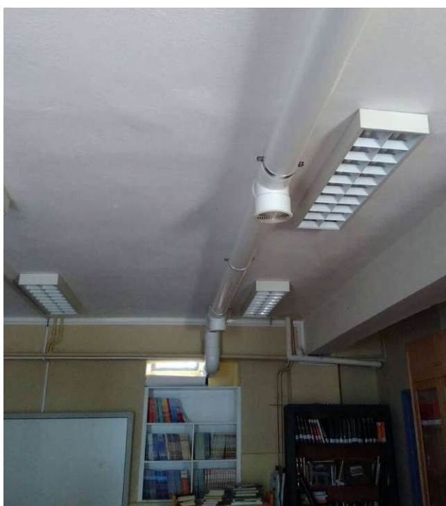
Ηλεκτρικός εξαερισμός στη βιβλιοθήκη
