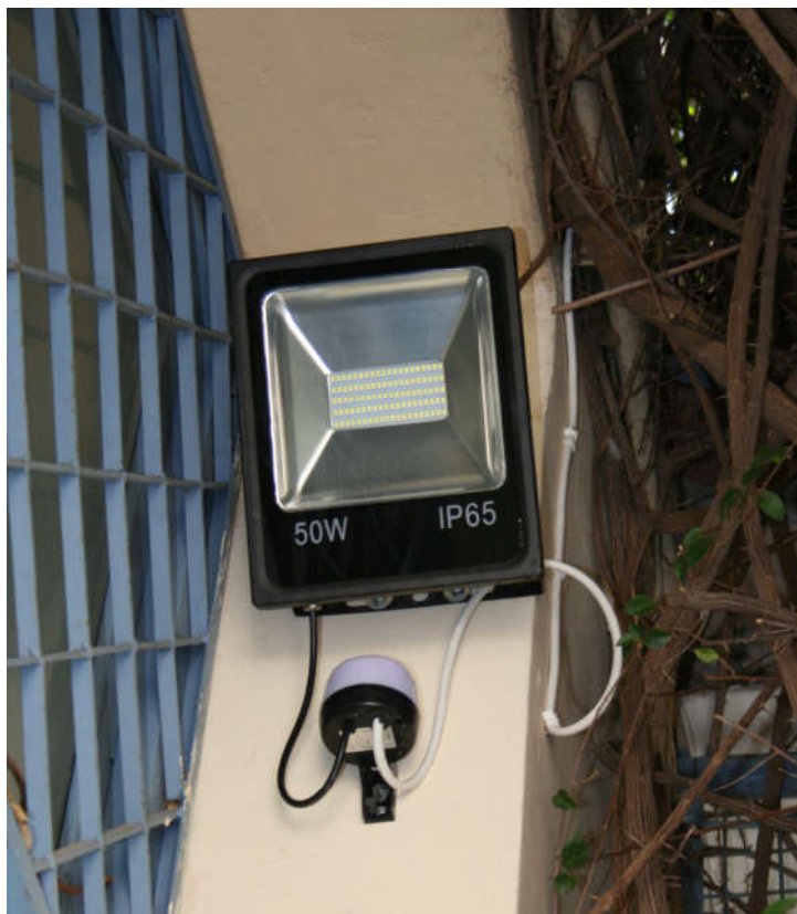
ρεοστατικός διακόπτης στον εξωτερικό λαμπτήρα
