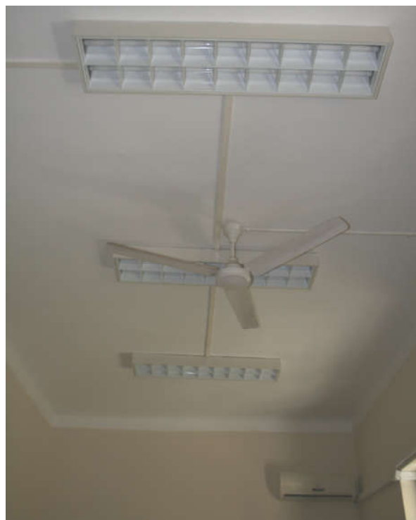
Λαμπτήρες φθορισμού στο Γραφείο Εκπαιδευτικών
